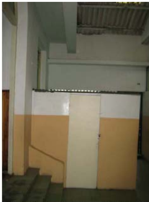
Por falta de espacio han tenido que construir esta mini aula, sin luz ni ventilación natural.
